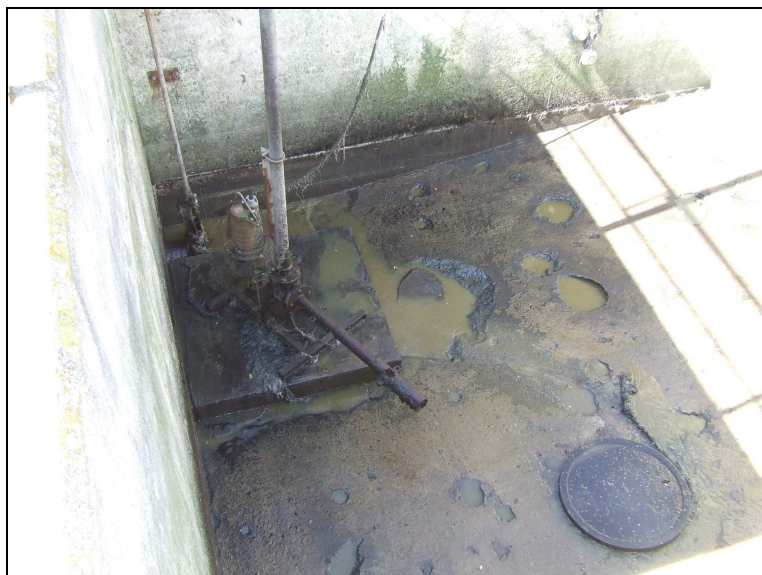
Ryc. 2 Strumienica w komorze retencyjnej (stan istniejący)
