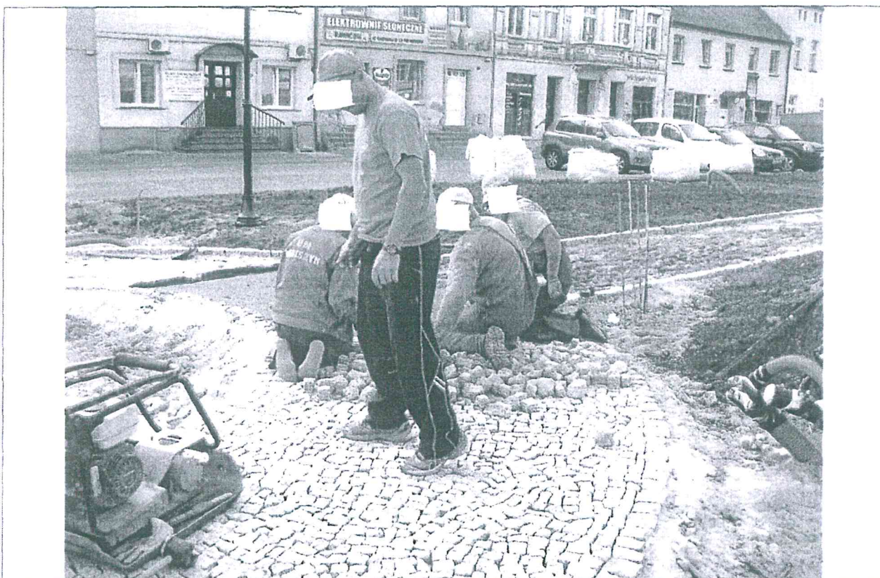
5 – pracownicy brygady Zbigniew Napierała, Grzegorz Olender, Kazimierz Kowalski, Kazimierz Warsz nie stosowali podczas pracy na budowie obuwia roboczego posiadającego właściwości ochronne oraz kamizelek ochronnych
